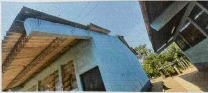
Foto 1: Se observa el techo en malas condiciones, por lo cual es necesario el cambio de laminas.
