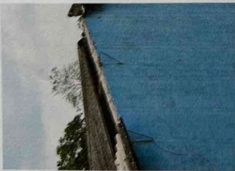
Foto 5: Techo en mal estado, se cambiara de lamina.
