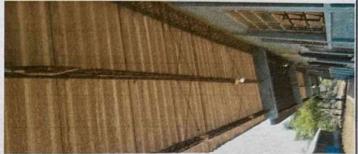
Foto 2: La estructura se encuentra en mal estado y oxidada, por lo cual se le va dar mantenimiento.
